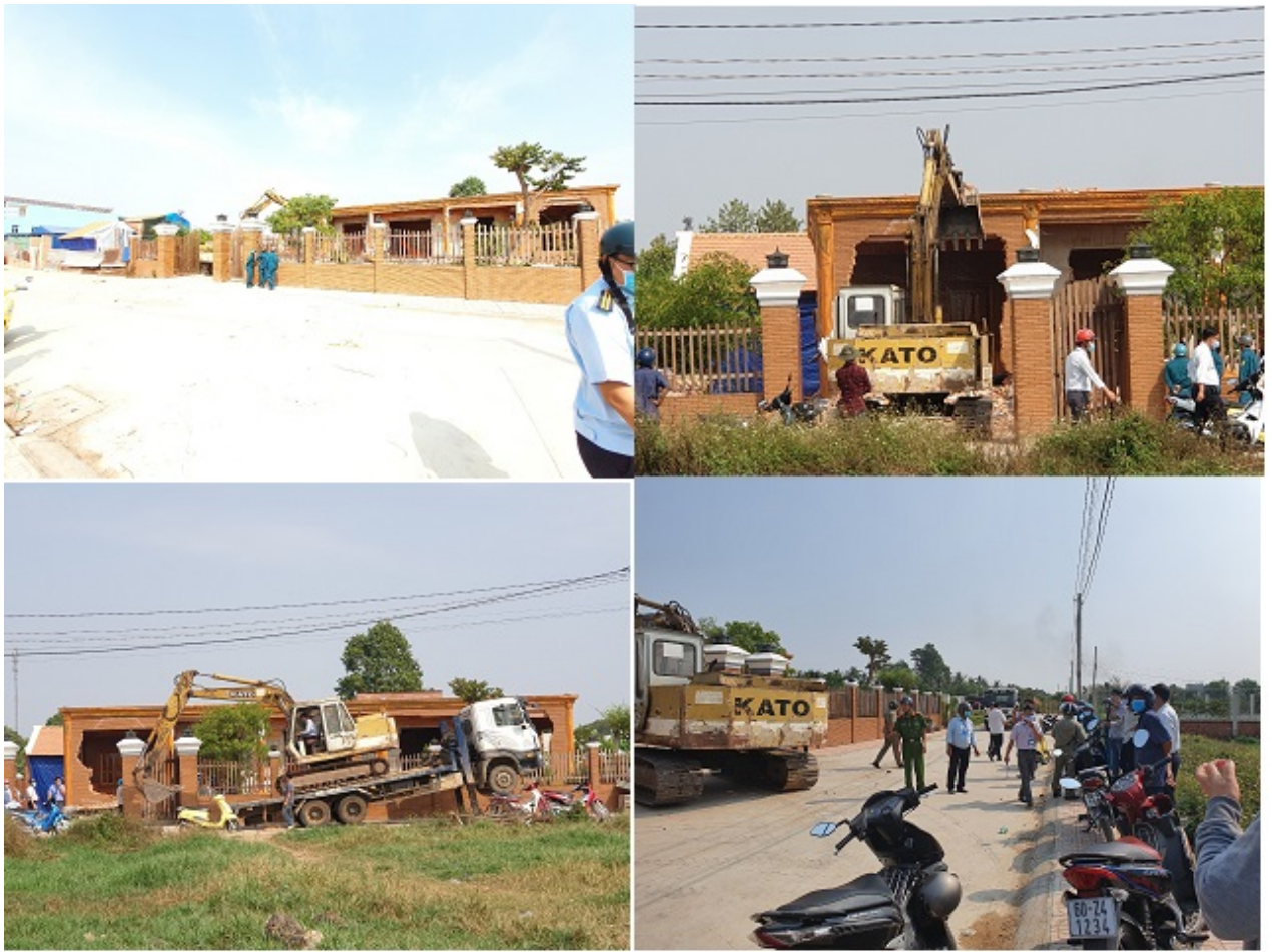
Một công trình sai phạm bị cưỡng chế lần 2 tại TP Biên Hòa (Ảnh: HD)
