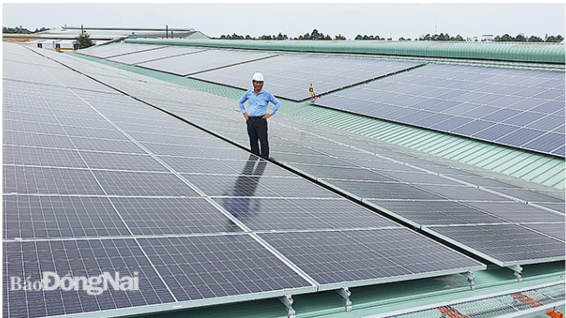
Trong hình là công trình điện mặt trời mái nhà trên mái nhà xưởng tại Khu công nghiệp Tam Phước. (Ảnh: Báo Đồng Nai)
