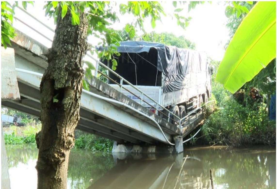
Cầu tải trọng chỉ 5 tấn không thể chịu được xe tải hơn 15 tấn chạy qua nên đã sập. Ảnh: QUỐC BÌNH.
