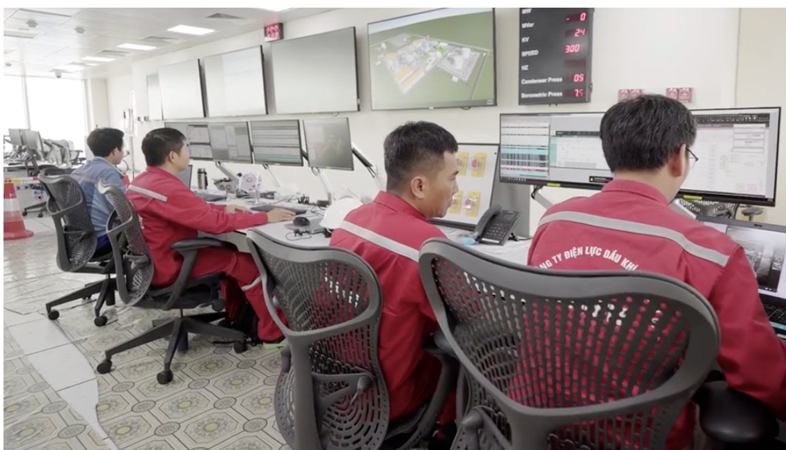
Bên trong Phòng điều khiển trung tâm Nhà máy điện khí LNG Nhơn Trạch 3&4. Ảnh: A.N/Bnews/vnanet.vn
