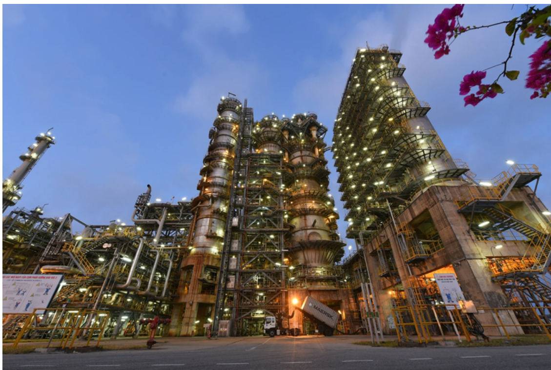
Phân xưởng RFCC – nơi được xem như trái tim Nhà máy Lọc dầu Dung Quất
