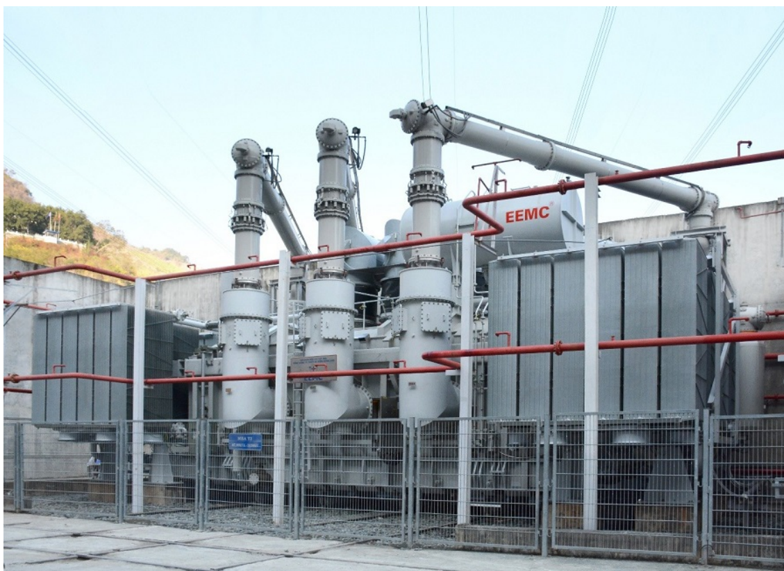
Máy biến áp 500 kV - 467 MVA tại nhà máy thủy điện Sơn La
