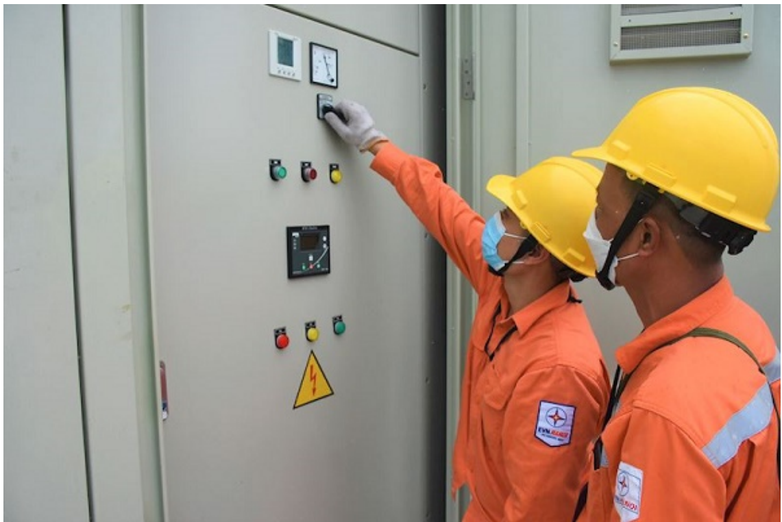
Đảm bảo cung cấp điện an toàn, ổn định
