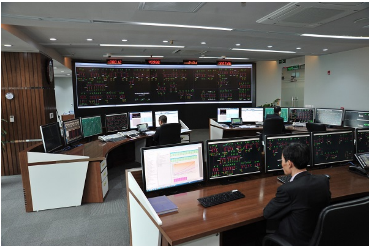
Trung tâm điều độ hệ thống điện Quốc gia
