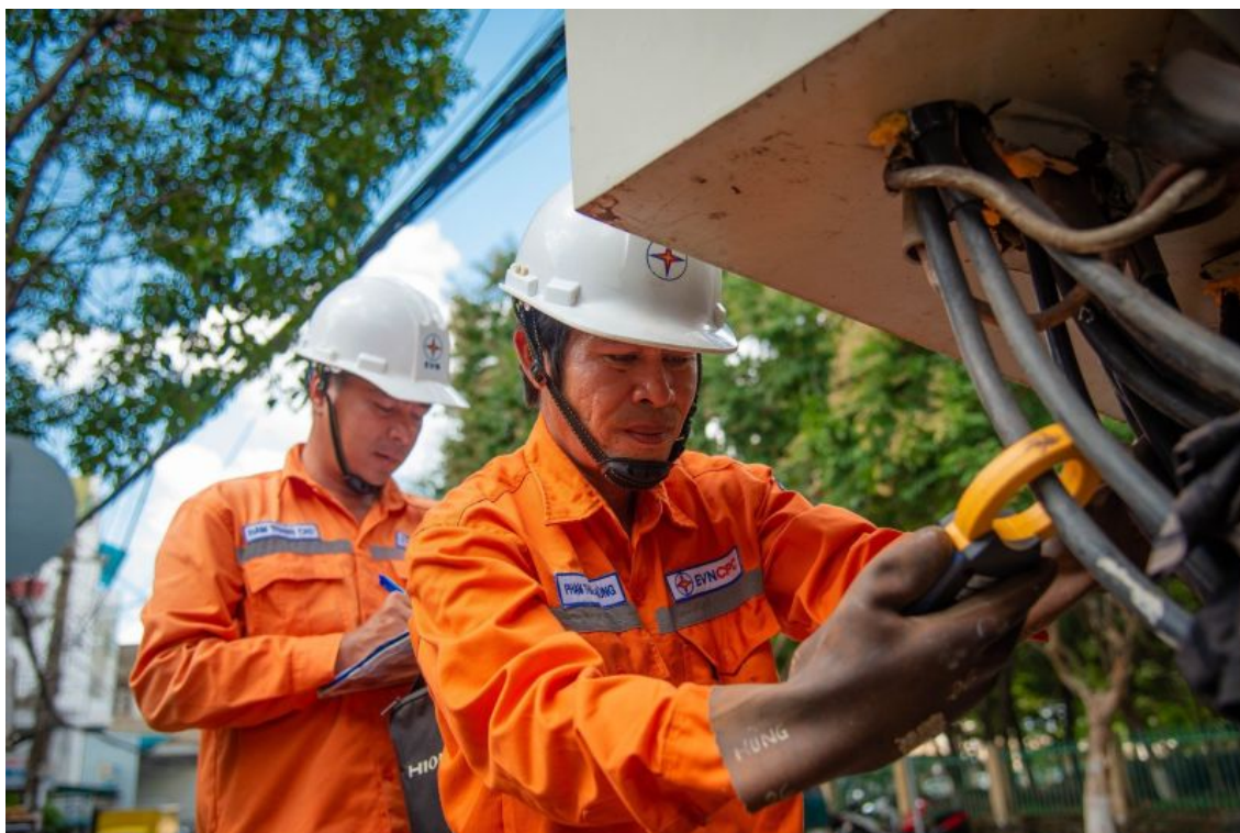
Các nhân viên điện lực kiểm tra hệ thống điện tại cơ sở
