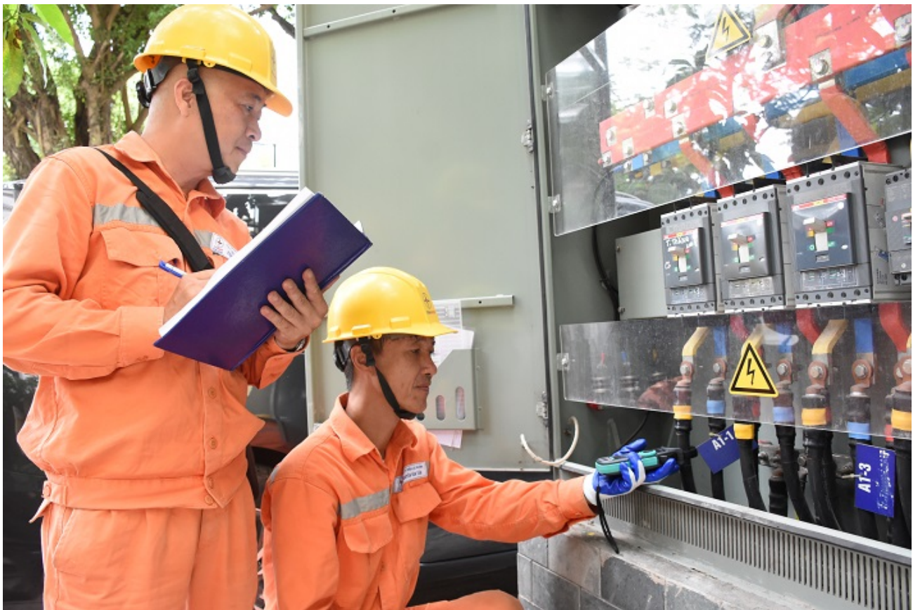
Các công nhân của EVNHANOI đang kiểm tra hệ thống điện
