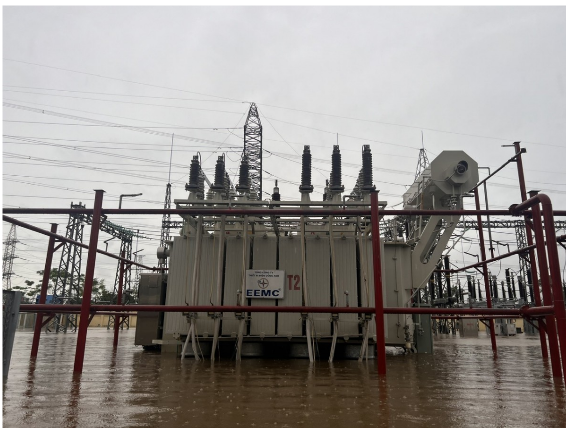
Trạm biến áp 110 kV Thường Tín cũng bị cô lập hoàn toàn do ngập lụt
