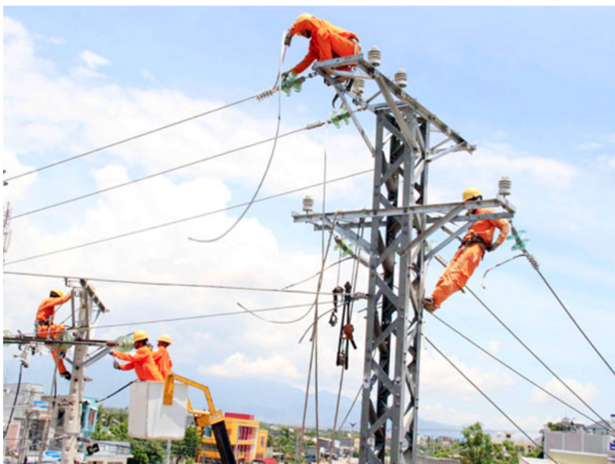
EVNNPC đảm bảo cung cấp điện an toàn, ổn định
