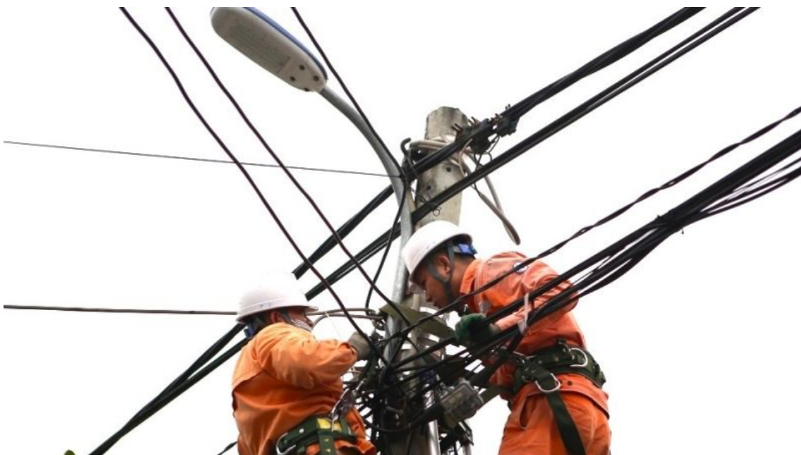
Điện lực Dương Kinh (PC Hải Phòng) chuẩn bị tốt lưới điện phục vụ mùa hè năm 2023.
