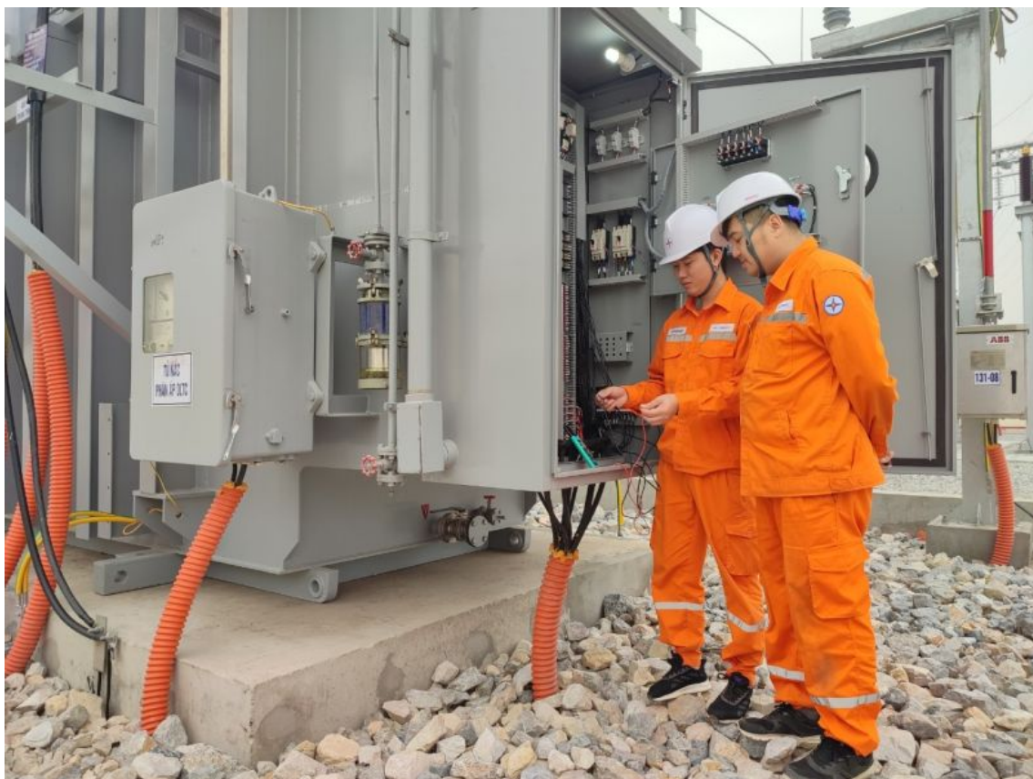
Kiểm tra hệ thống mạch nhị thứ trước khi đóng điện trạm 110kV Thái Hưng, Thái Bình.
