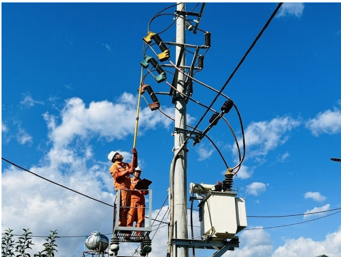
Đảm bảo cung cấp điện an toàn, ổn định
