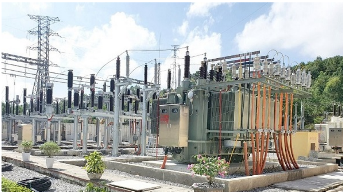
Máy biến áp T2 40MVA TBA 110kV Tỉnh Gia 2 vận hành theo chế độ TBA điều khiển xa, không người trực
