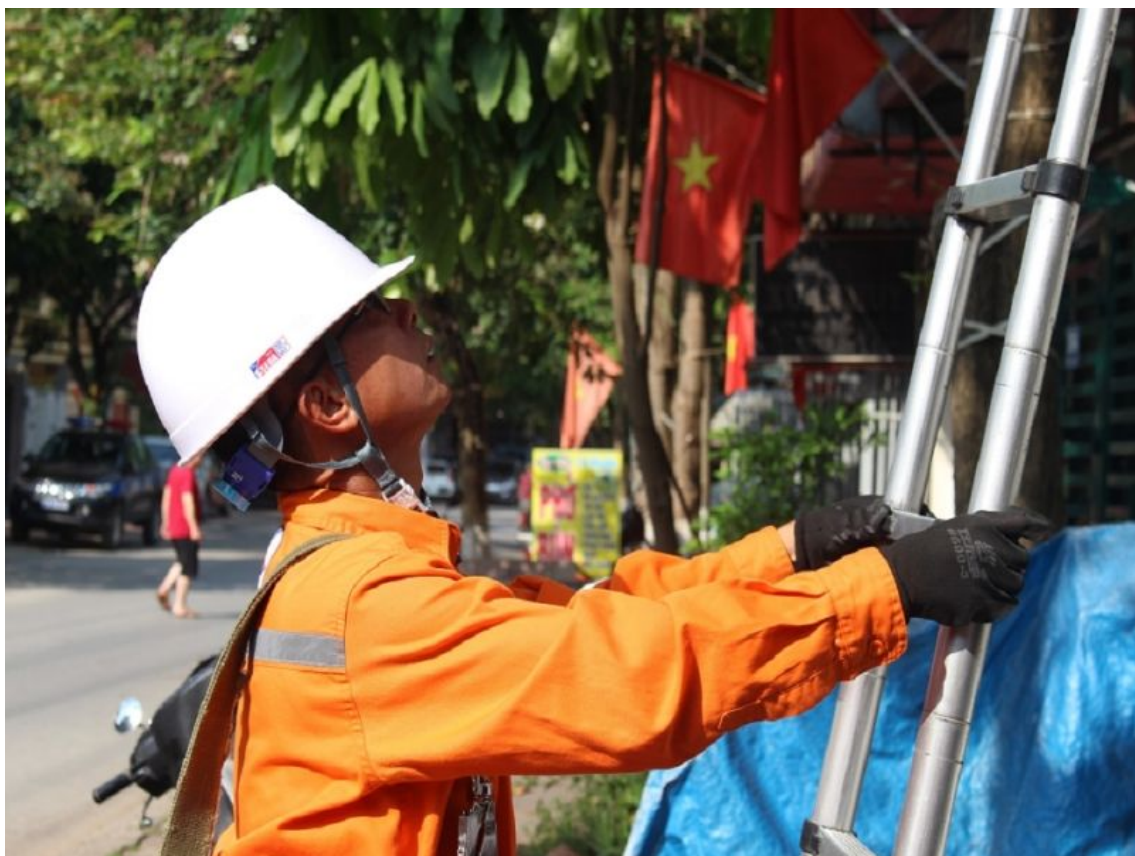
Điện lực thành phố Lạng Sơn nỗ lực cấp điện an toàn, liên tục trong mùa nắng nóng
