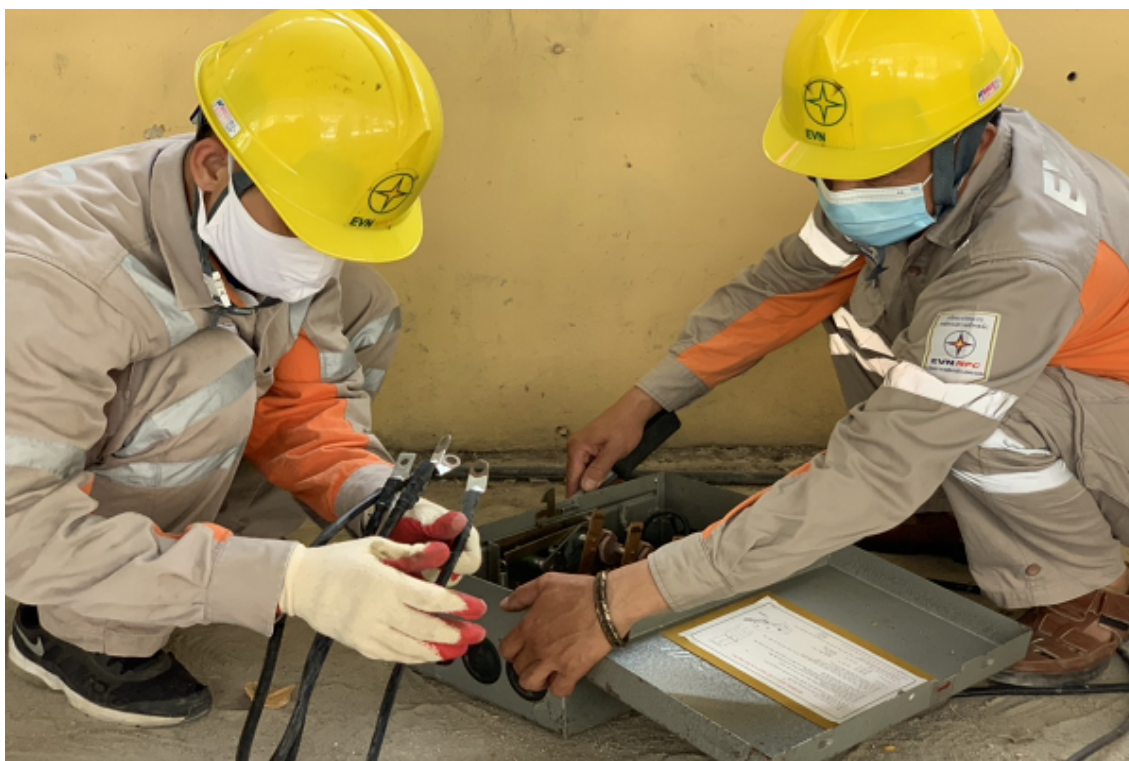
Đảm bảo công tác cung cấp điện an toàn
