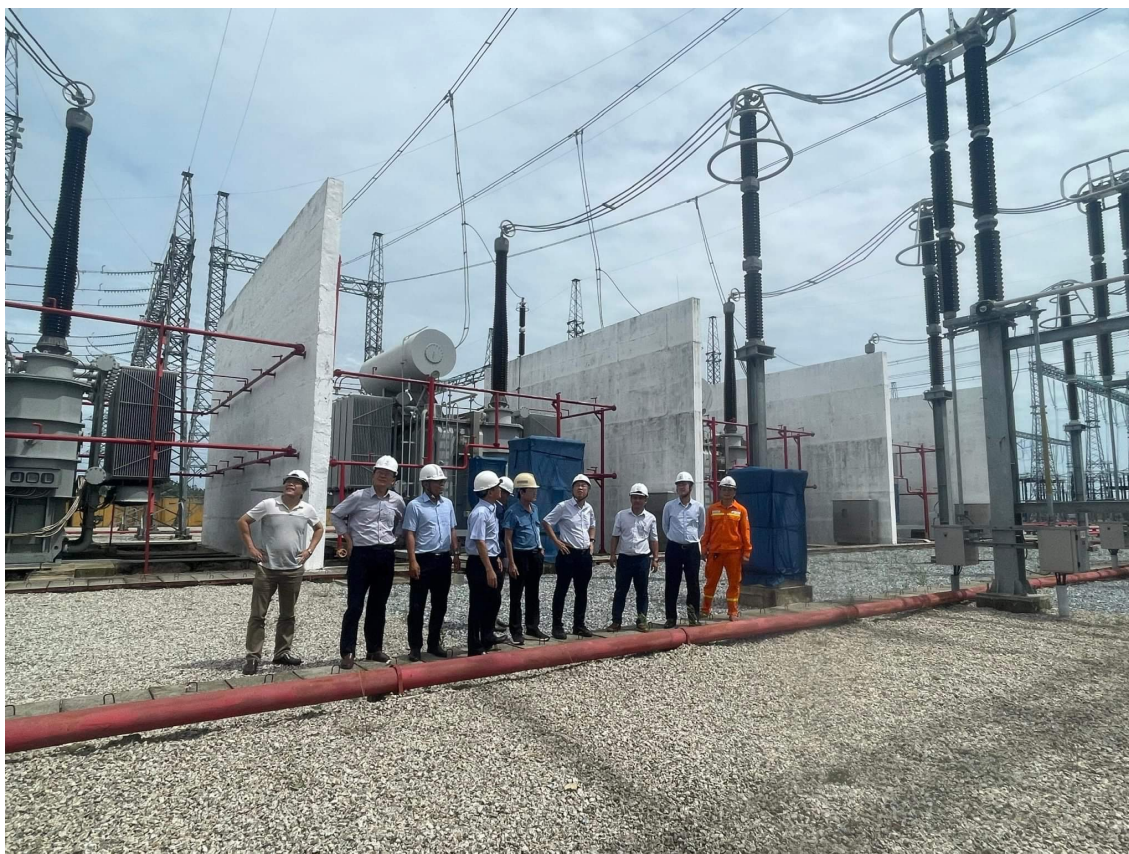
Đoàn công tác của EVNNPT kiểm tra TBA 500kV Dốc Sỏi, sáng ngày 28/09.
