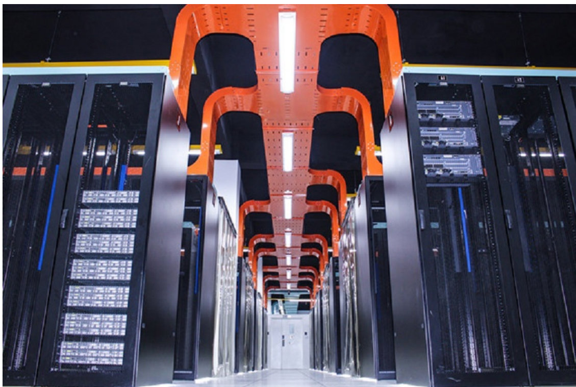
FPT khai mở Data Center “khủng”, tăng nhiệt đường đua kinh tế số (Ảnh: internet)
