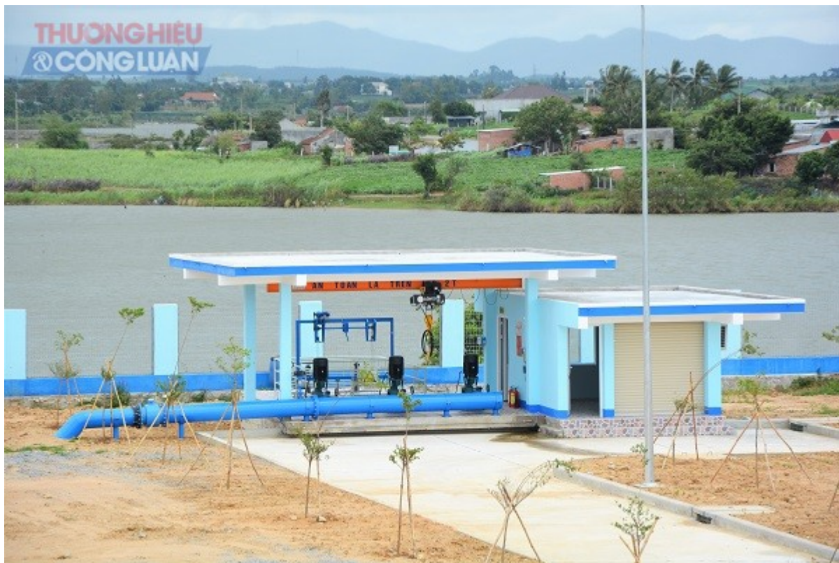
Trạm bơm cấp 1 lấy nước trực tiếp từ lòng hồ An Khê-Ka Nak
