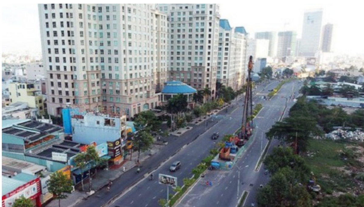
Đường Nguyễn Hữu Cánh đoạn phải nâng cao.
