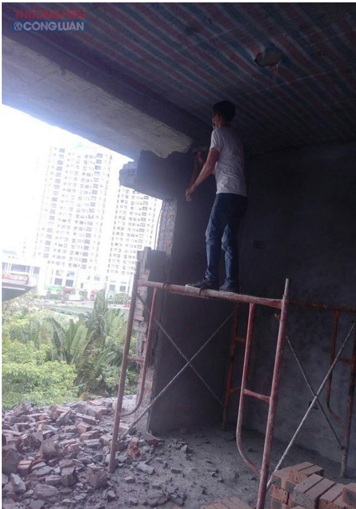
Tổ công tác của quận Bắc Từ Liêm tổ chức cưỡng chế công trình vi phạm trật tự xây dựng tại khu đô thị Thành phố Giao lưu (phường Cổ Nhuế 1, quận Bắc Từ Liêm, TP. Hà Nội)
