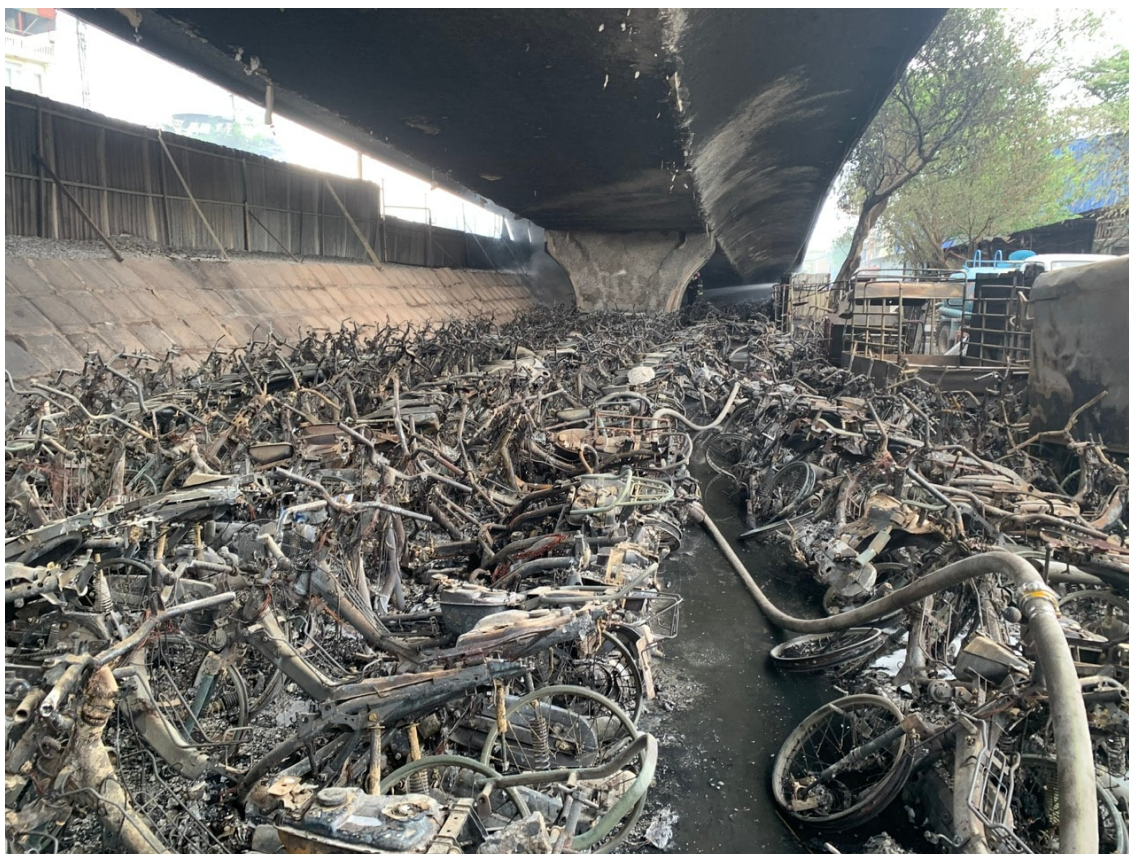
Vụ cháy cháy bãi xe dưới gầm cầu Vĩnh Tuy (ngày 30/8) khiến hơn 500 xe máy bị thiêu rụi, làm lớp bê tông bảo vệ dầm cầu từ trụ T1 đến T3 bị lửa nung nóng và bong tróc, lộ bản giằng thép... Ảnh: VT
