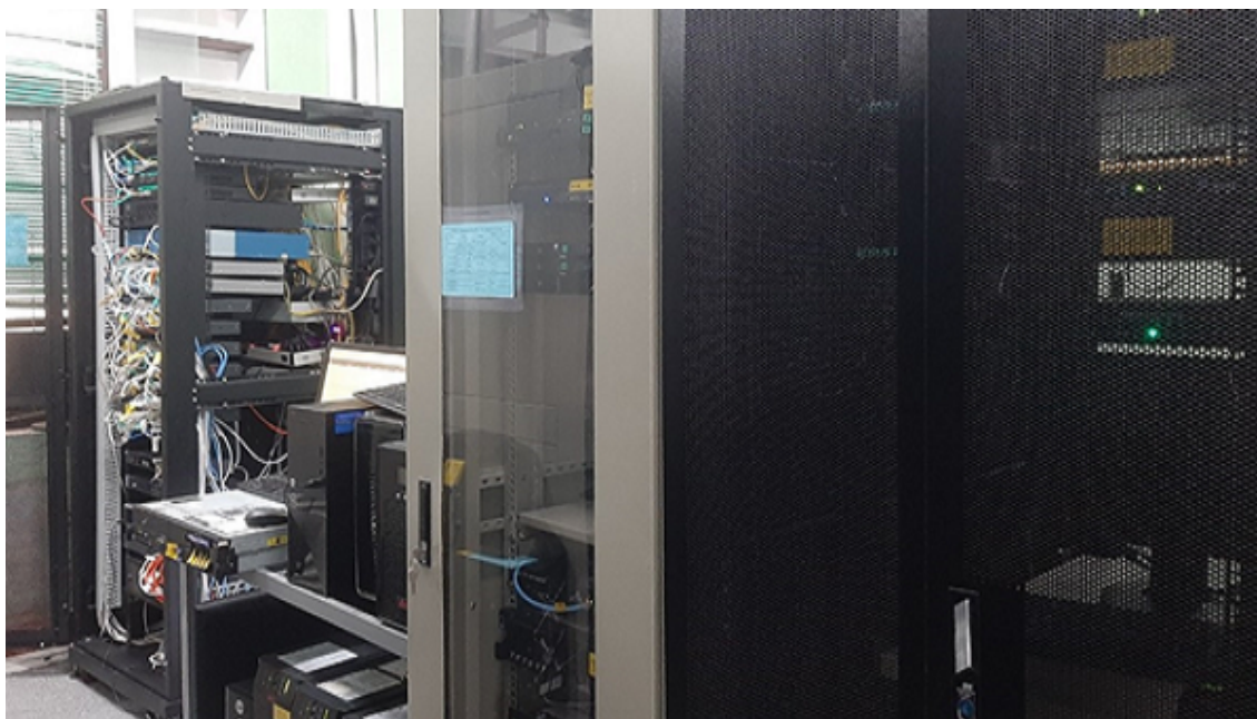
Công ty Điện lực Bắc Giang nâng cấp thiết bị phòng đặt máy chủ ngày 7/8/2021
