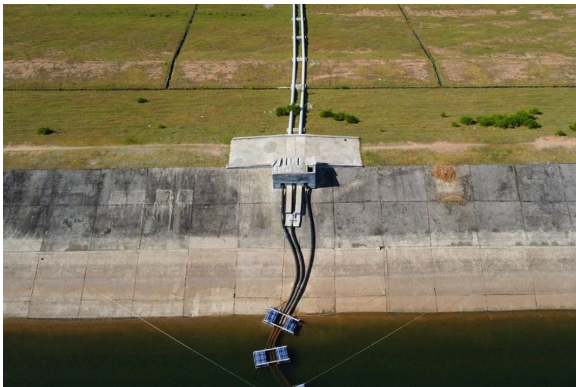
Hệ thống xi phông dẫn nước từ hồ chứa nước Cu Lây về bể lắng nhà máy trước khi xử lý.
