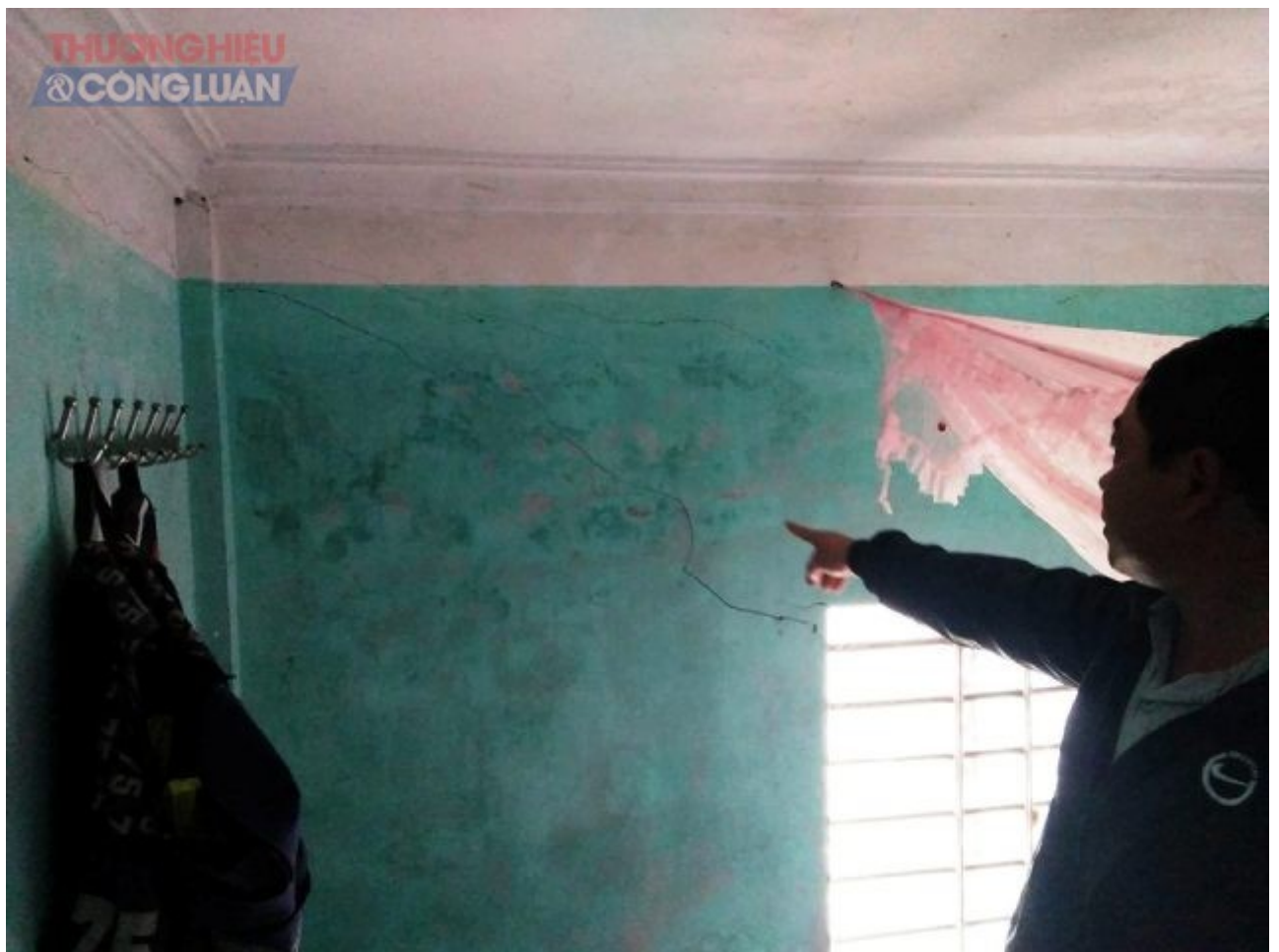
Ông Trinh cho rằng những vết nứt trên tường xuất hiện từ lúc xưởng cơ khí Tiến Minh đưa vào hoạt động
