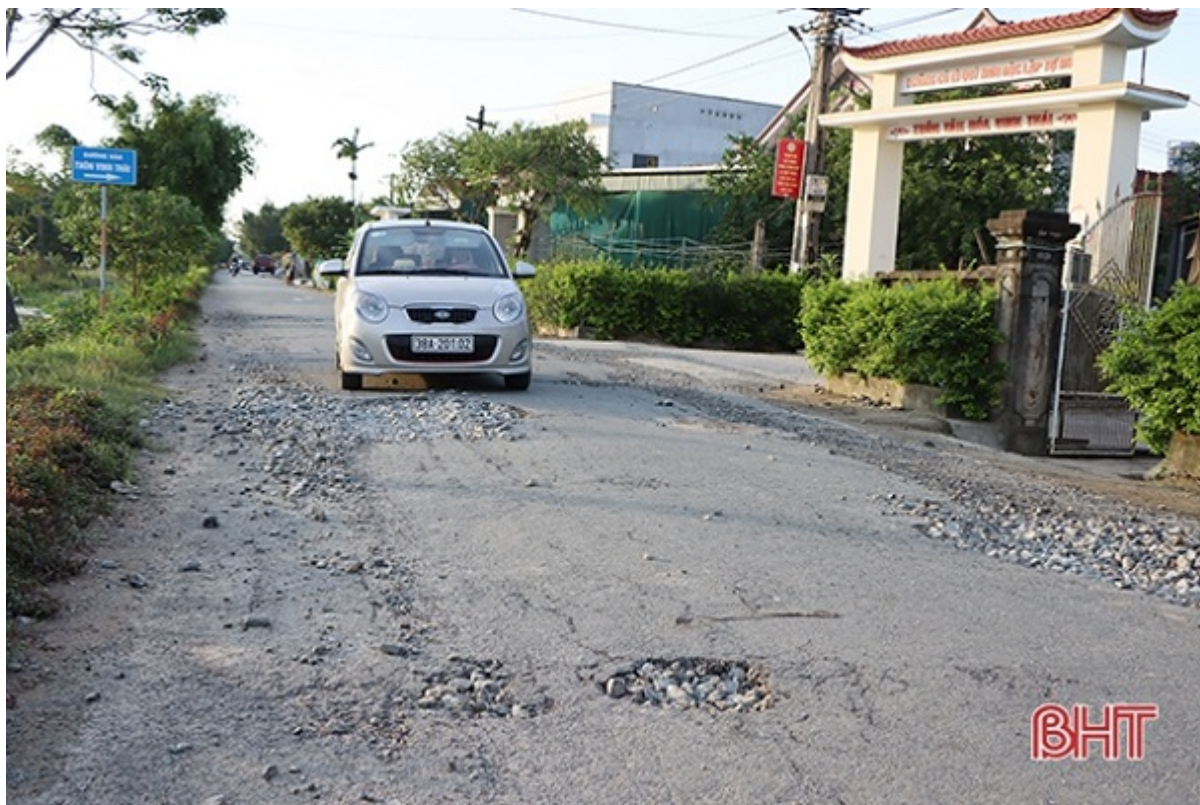
Nhiều tuyến đường bị hư hỏng sau lũ. Ảnh: Báo Hà Tĩnh
