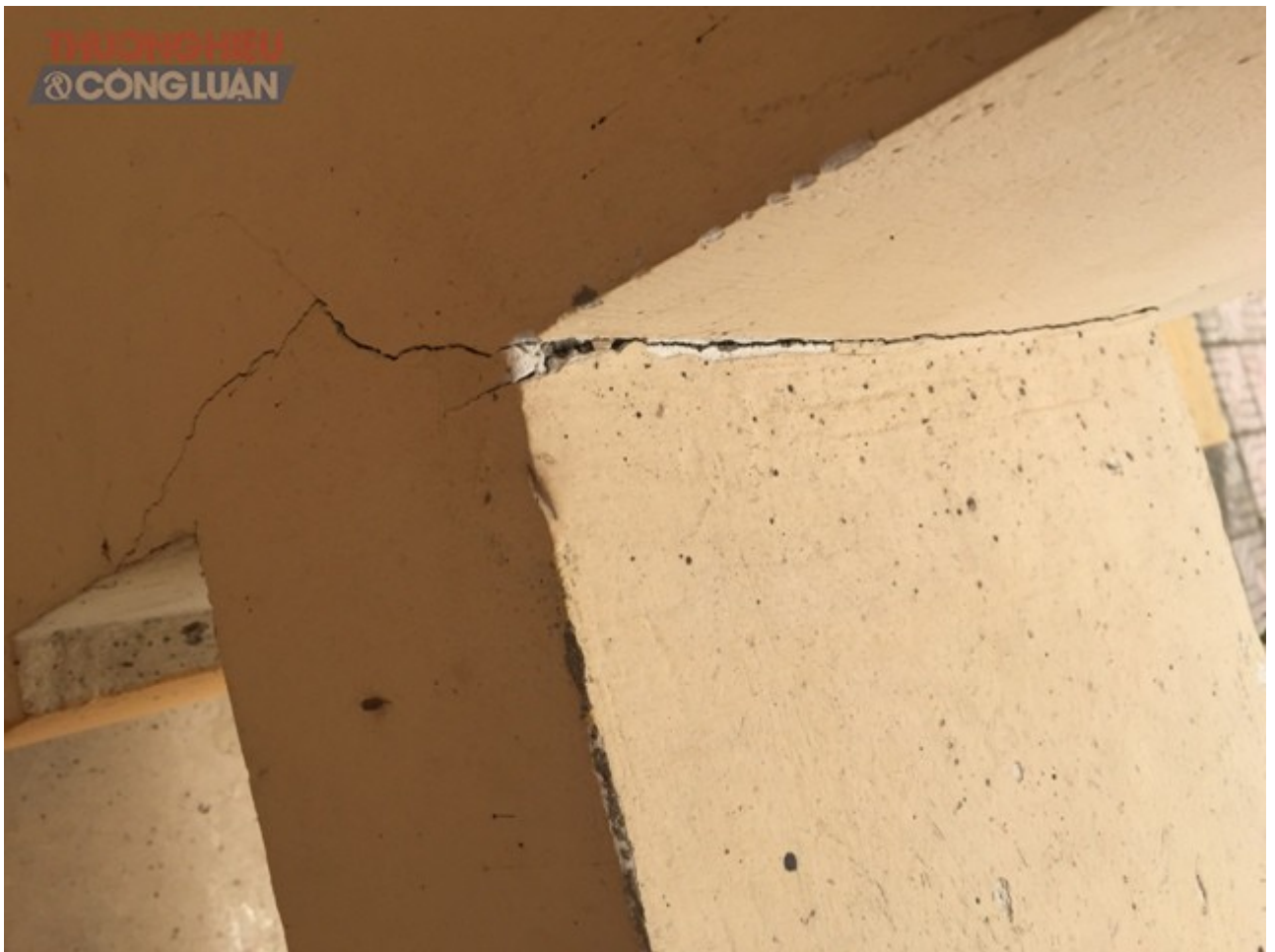
Dầm trụ cũng bị nứt
