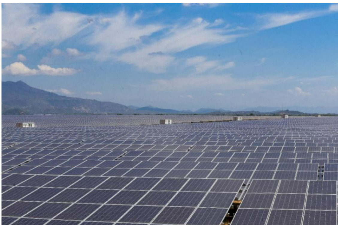
Cụm 3 nhà máy điện mặt trời BIM tại Ninh Thuận có tổng công suất tối đa 405MWp.
