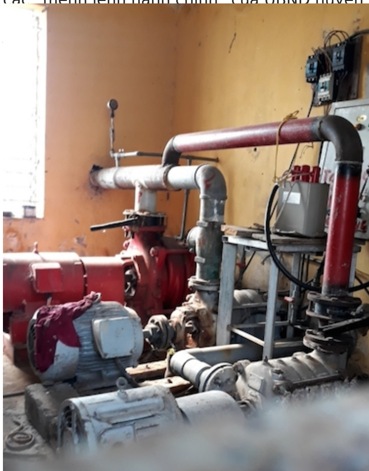
Hệ thống máy bơm nhà máy
