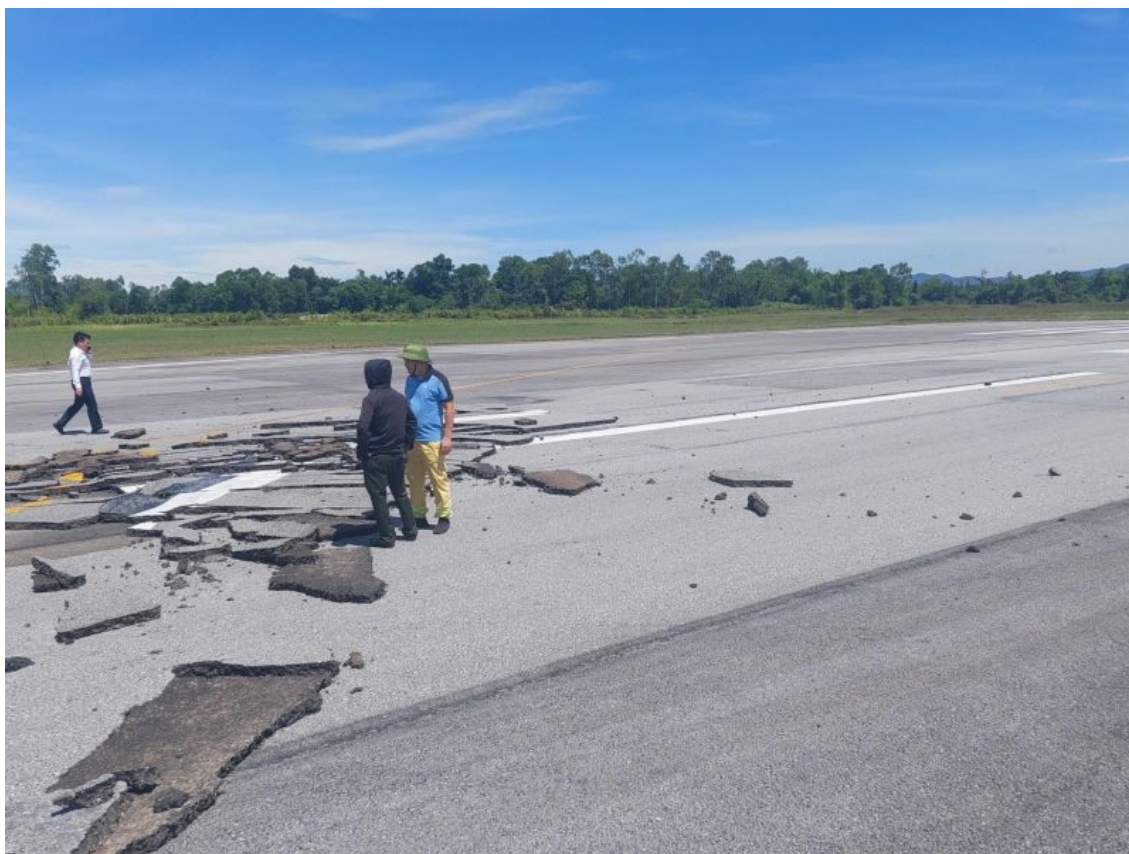
Đường băng ở sân bay Vinh bị bong một mảng lớn
