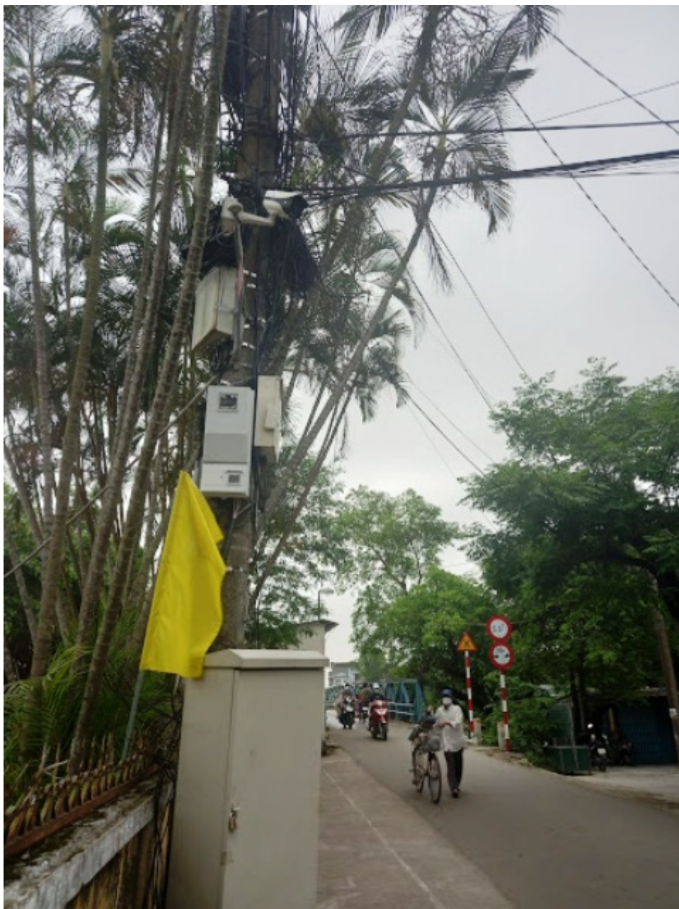
Camera an ninh được bắt ở cầu Phú Lưu, phường Võ Dạ (Huế).
