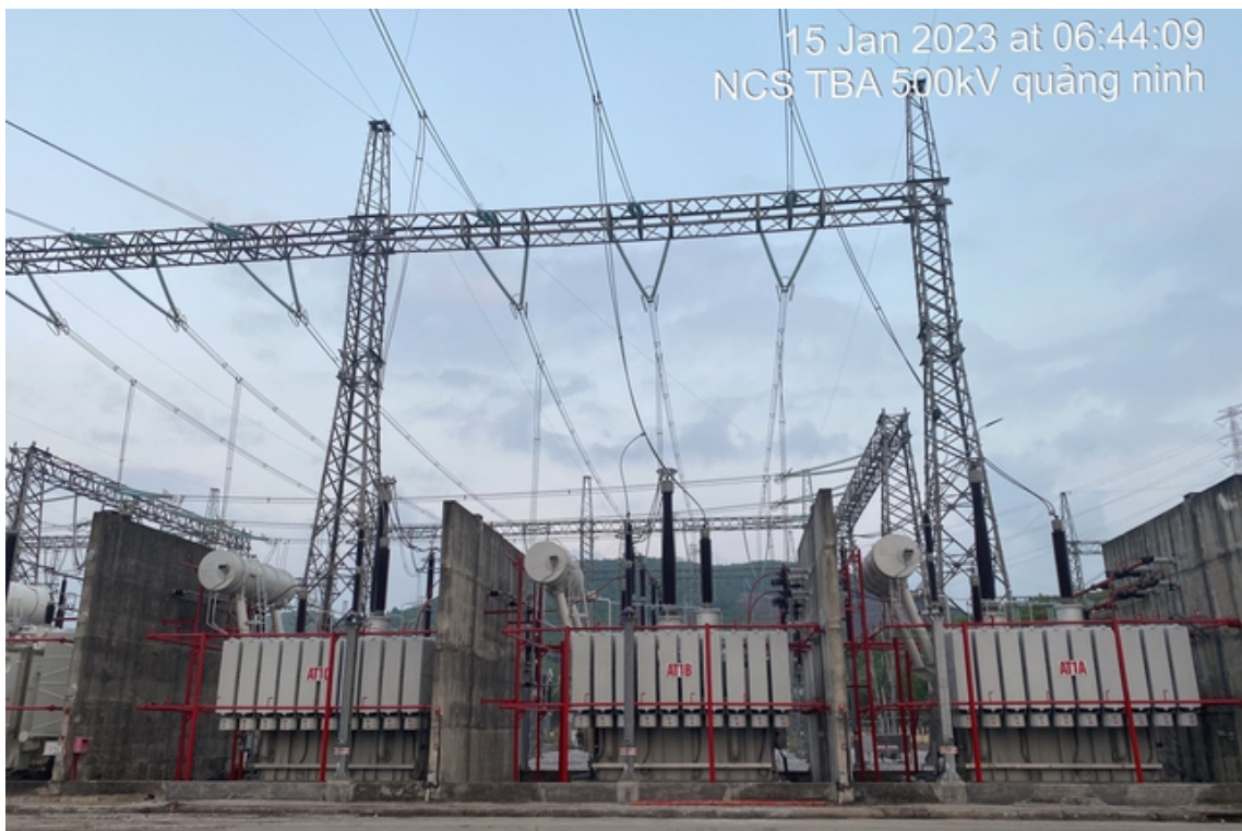
Máy biến áp AT1 - 600MVA TBA 500kV Quảng Ninh-Ảnh:VGP/Toàn Thắng.
