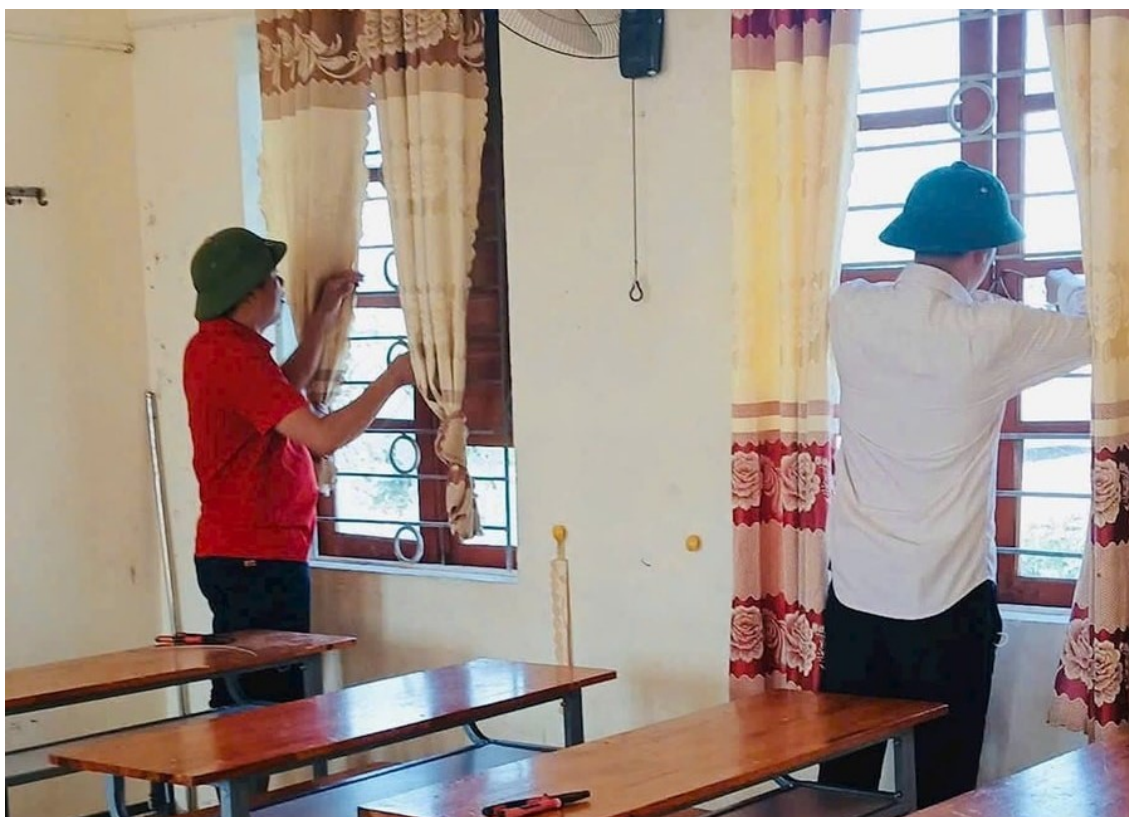
Kiểm tra cơ sở vật chất trường lớp, đảm bảo an toàn, tránh hư hỏng.
