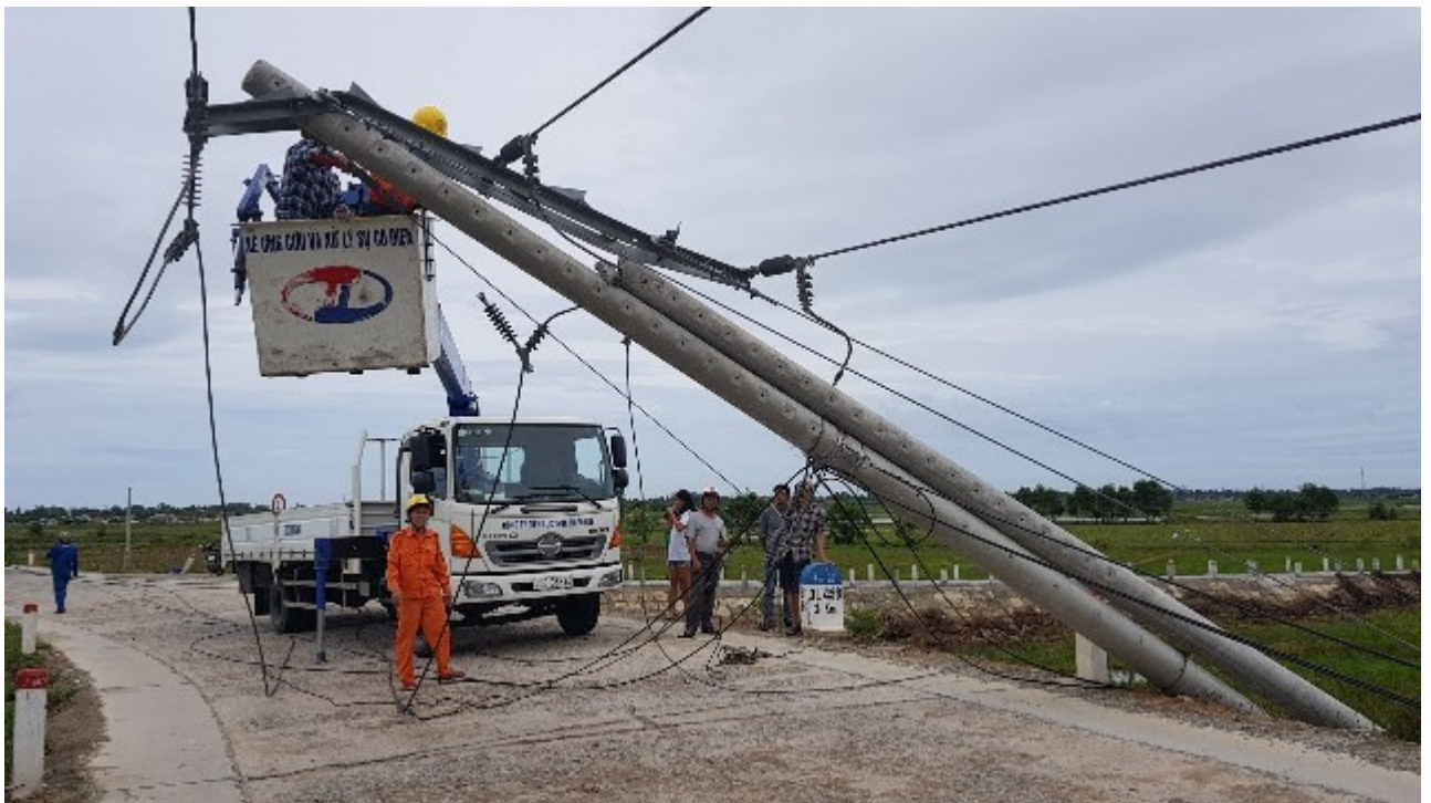
Nhiều cột điện bị gãy đổ
