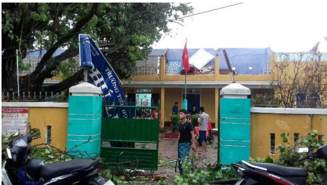
Trường tiểu học Phú Lưu (KV6 phường Vỹ Dạ) tồn tại trước 1975 không được đầu tư, bị sập đổ trong bão số 5 vừa qua
