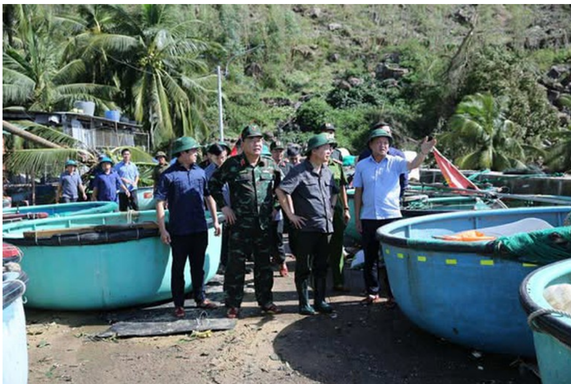
Phó Thủ tướng kiểm tra kè chắn sóng thôn 2, xã Xuân Lộc, tỉnh Đắk Lắk bị sóng biển đánh tràn kè khi bão số 13 quét qua - Ảnh: VGP/Minh Khôi
