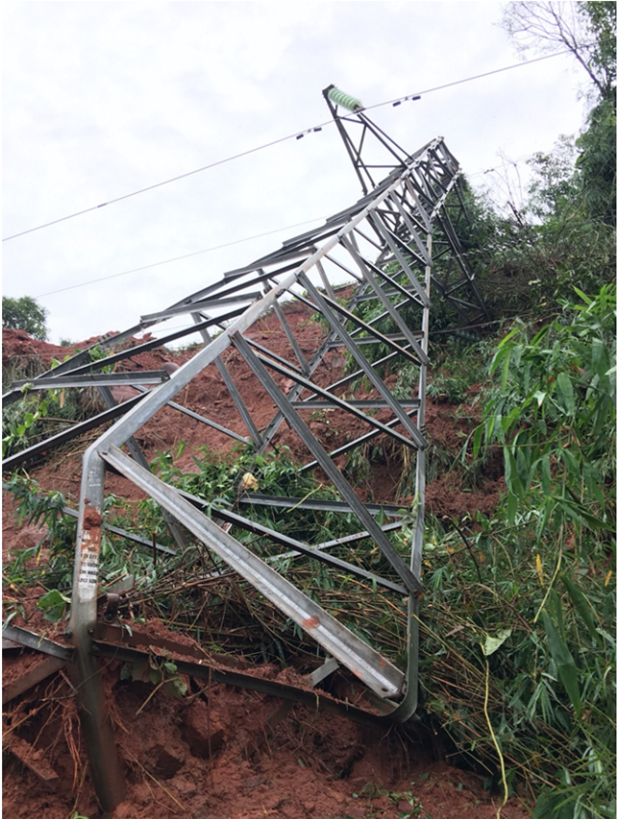
Mưa lũ đã gây sạt lở đổ cột điện tại vị trí 253 Đường dây 110 kV Thủy điện Tó Buông - Tắt Ngoẳng
