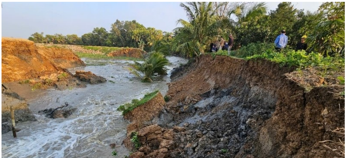
Sự cố sạt, lở bờ kênh Sông Mơ thuộc hệ thống kênh Nhà Lê tại xã Đông Nam, TP. Thanh Hóa.
