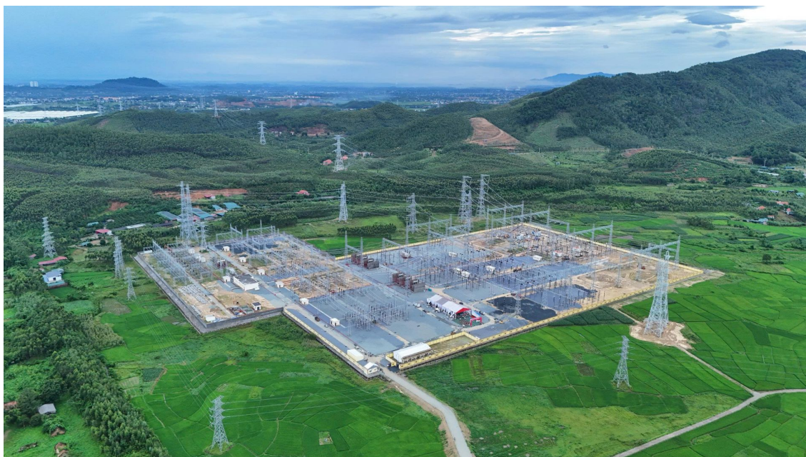
Toàn cảnh Trạm biến áp 500kV Vĩnh Yên và đường dây đấu nối
