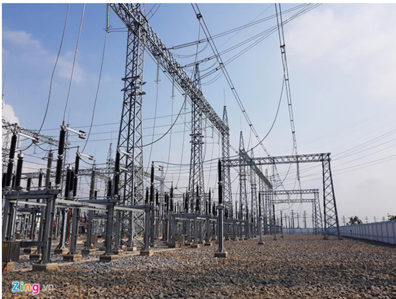
Trạm biến áp truyền tải điện (Ảnh: Zing.vn)
