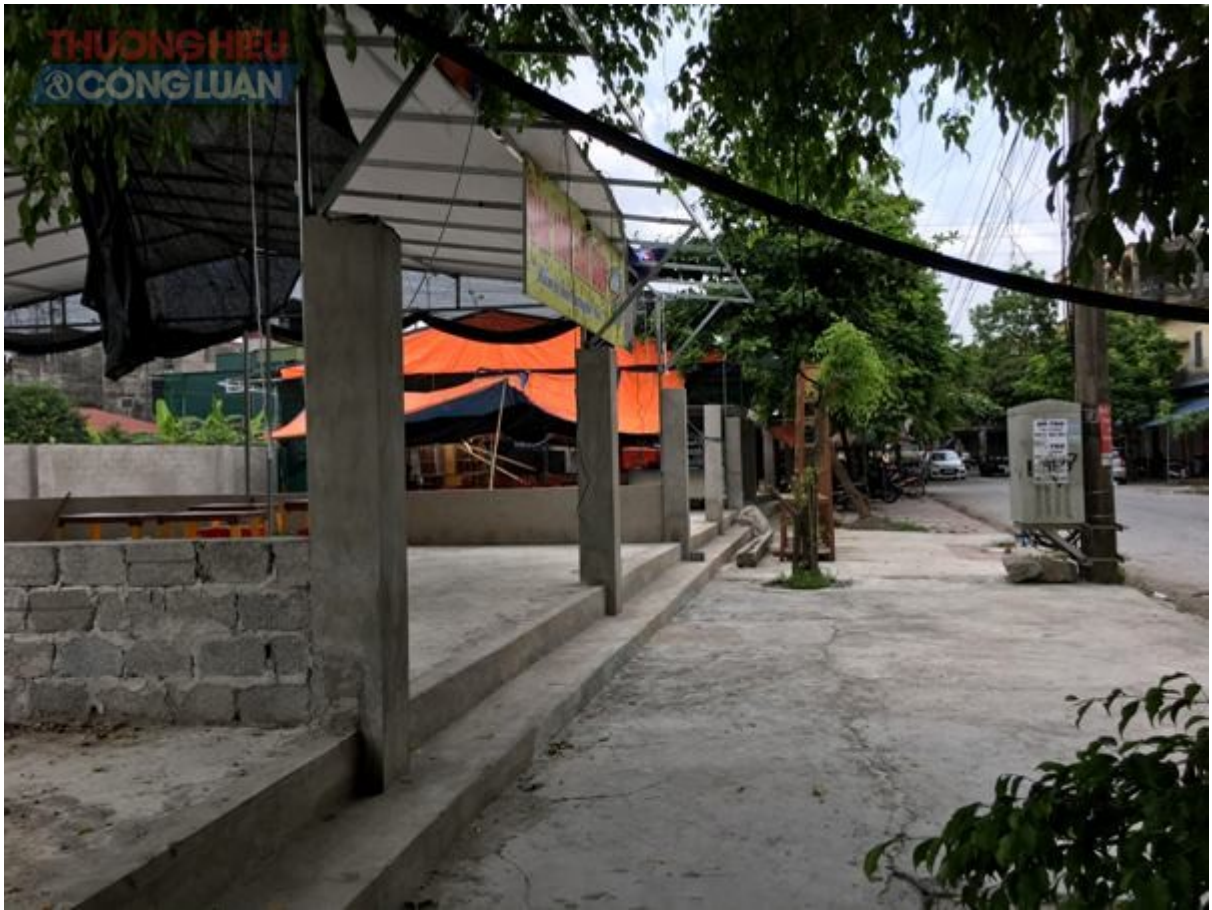
Một số kiot dựng mái che vi phạm trật tự xây dựng (Ảnh chụp ngày 31/5/2018)
