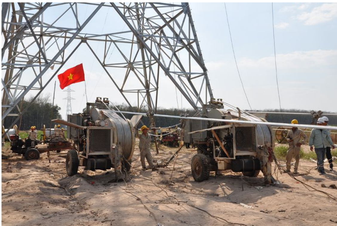
Đường dây 500 kV Pleiku - Mỹ Phước - Cầu Bông do 23 đơn vị cùng tham gia thực hiện
