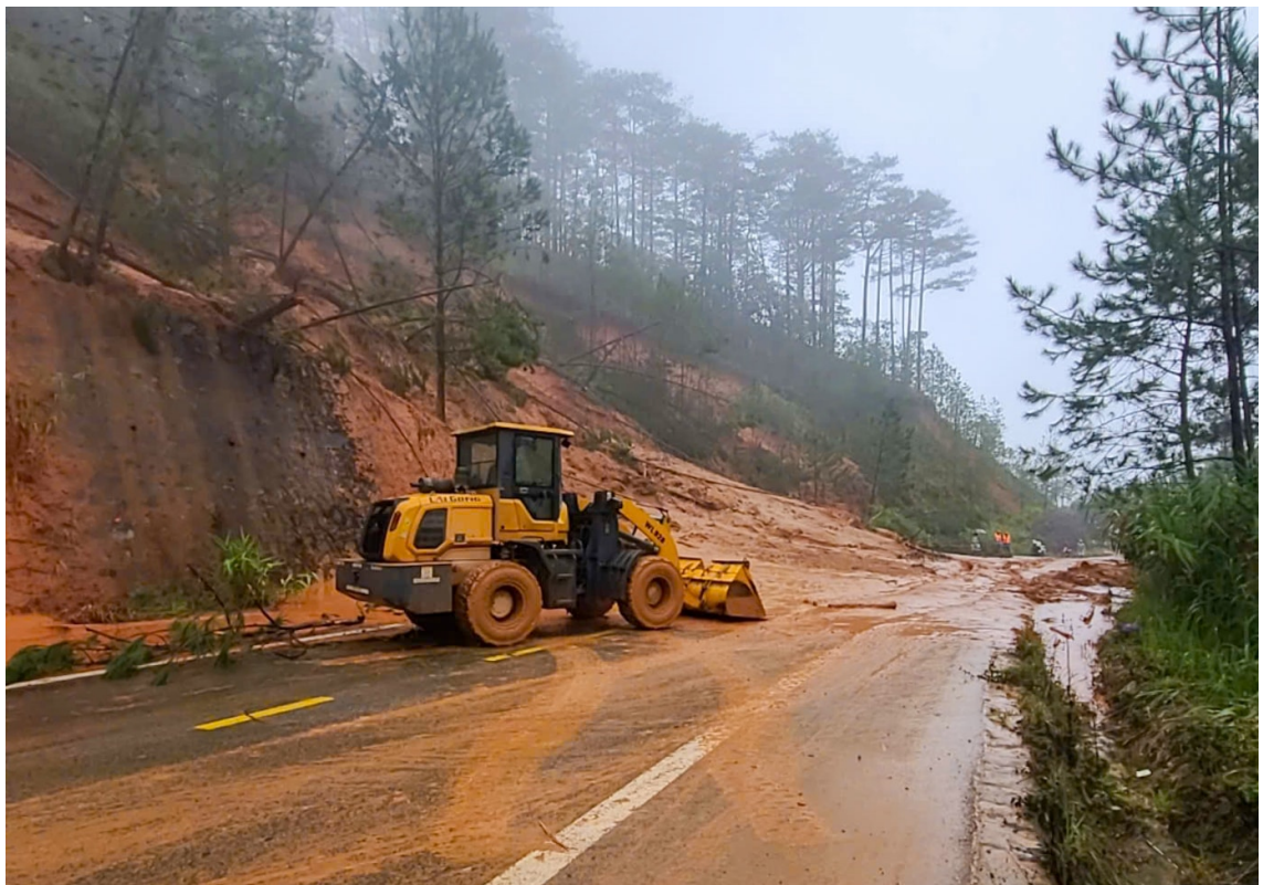
Taluy âm Km83+750 bị sạt đang được Sở Xây dựng tổ chức thu dọn đất đá tràn xuống mặt đường (Ảnh: KT)
