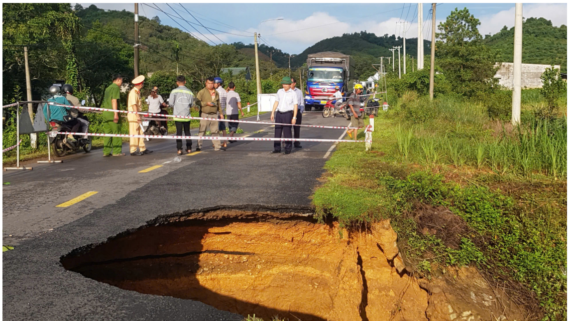
Sạt lở ăn sâu vào gần một nửa mặt đường Tỉnh lộ 721 đoạn qua xã Đạ Lây. Ảnh Báo Lâm Đồng.
