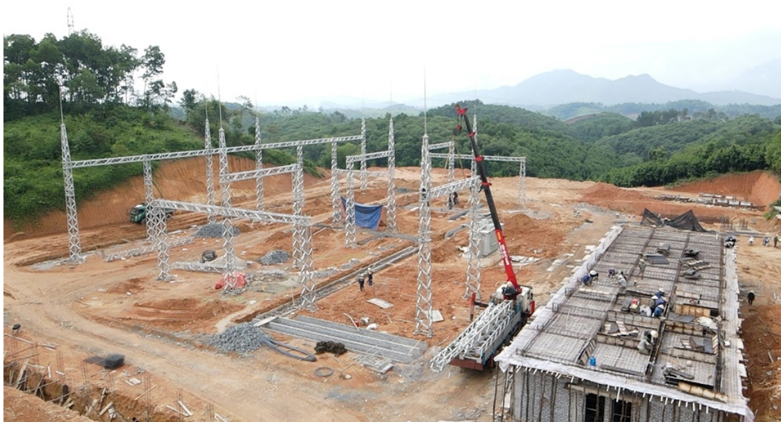
Trạm biến áp 110kV Bảo Hưng
