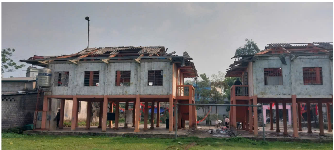
Hàng loạt nhà dân và công trình công cộng tại Nghĩa Lộ bị gió lốc thổi bay phần mái.
