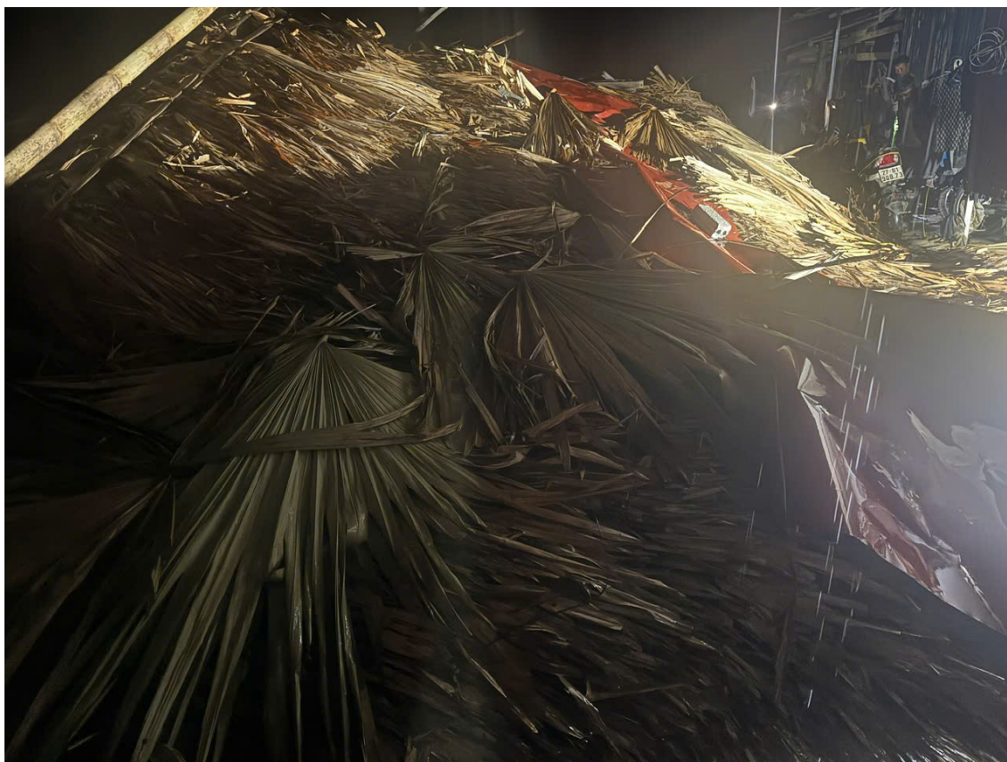
Mưa đá kèm giông lốc làm sập nhà sàn tại thôn Cồ Dề Chải
