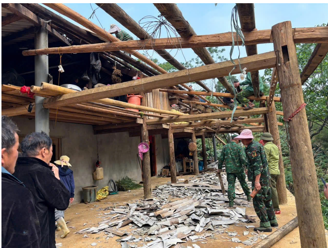
Mưa lớn kèm dông lốc khiến ngôi nhà của gia đình ông Tráng A Lừ (thôn Cán Chư Sủ, xã Si Ma Cai) bị tốc mái
