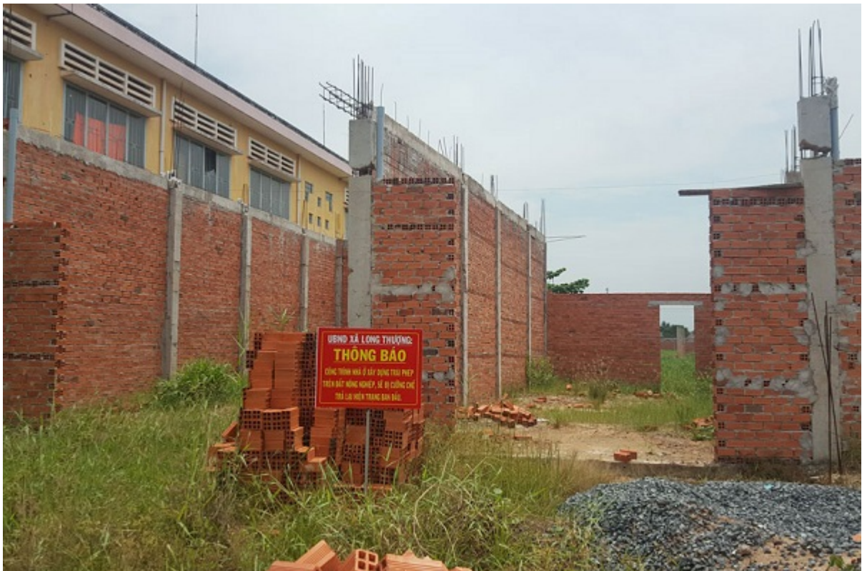
Một công trình xây dựng trái phép trên đất nông nghiệp ở xã Long Thượng, huyện Cần Giuộc
